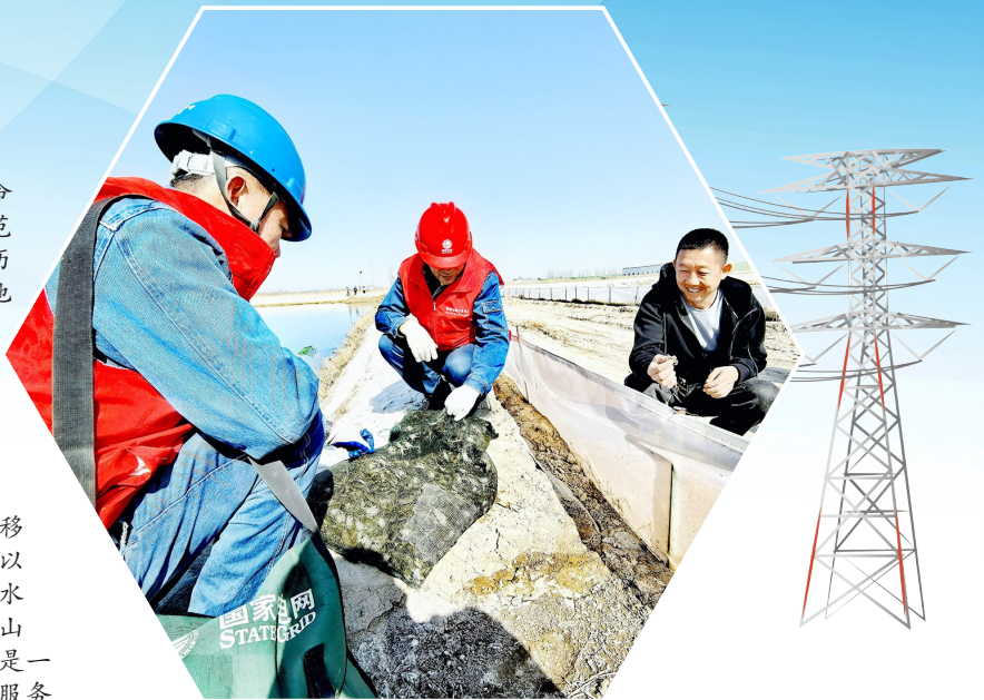
▲在贺兰县立岗镇永兴村“以渔治碱”示范基地,国家电网宁夏电力(闽宁山海情贺兰)共产党员服务队队员为蟹塘供电线路“把脉问诊”。
