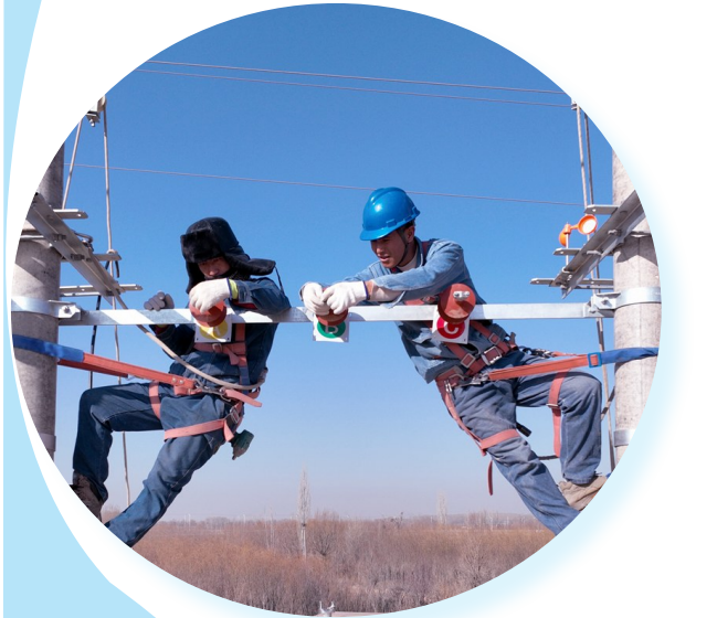
电力工人在变电站检修设备。
