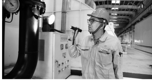
在国能宁夏灵武发电有限公司，运行人员加强四台332万千瓦运行机组巡回检查力度，确保迎峰度夏电力供应。
