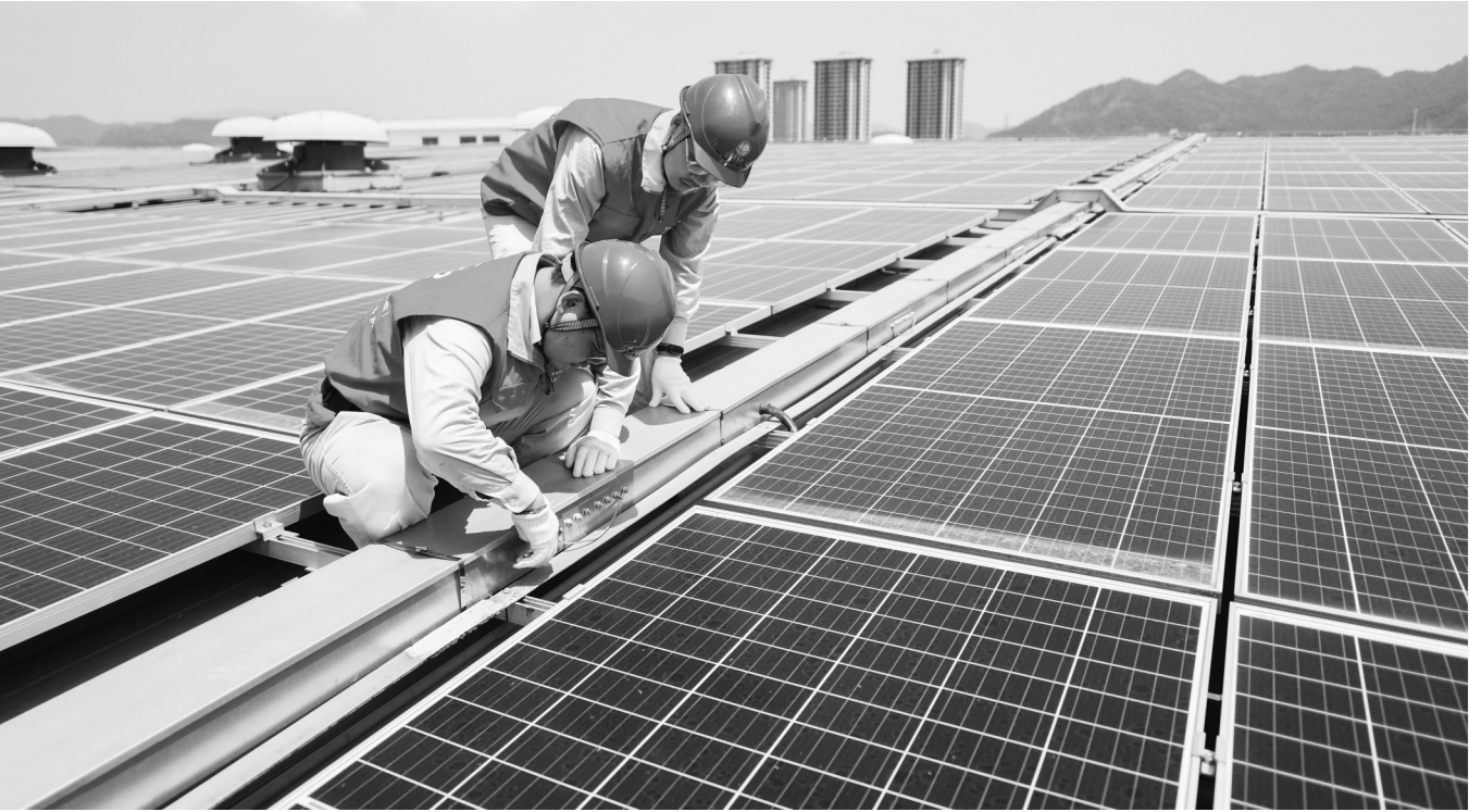
7月26日，工作人员在横店影视产业园一座大型摄影棚的屋顶巡检光伏发电设备。 近年来，为实现节能降耗、低碳减排，浙江省东阳市横店影视产业园利用大型摄影棚屋顶推进光储充一体化“绿色”摄影棚建设。 横店影视产业园目前有12个摄影棚投入使用。该产业园与东阳供电公司共同推进光储充一体化“绿色”摄影棚建设，以“棚内拍戏，棚顶发电”的方式最大化利用摄影棚空间资源。截至目前，已有9个大型摄影棚棚顶完成屋顶分布式光伏电站的安装并投运，总装机容量为5310.54千瓦，预计年均发电量将达550万千瓦时。 新华社发
