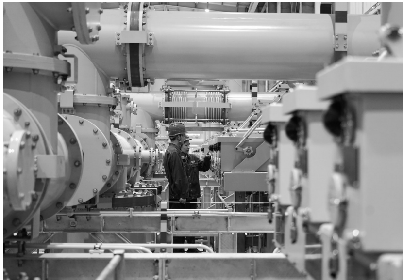
工作人员在江西鄱阳湖换流站巡视(6月18日摄)。 6月21日,四川雅中到江西鄱阳湖±800千伏特高压直流输电工程正式投运。该工程是国家电网服务“西电东送”能源战略的重大项目,途经四川、云南、贵州、湖南、江西5省,全线总长约1696千米,设计年输送电量360亿千瓦时。 新华社发
