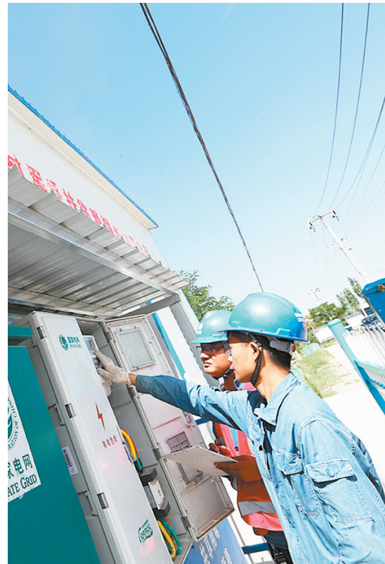
在麻黄沟村，电力工人在巡检“固定式共享电源”运行情况。
