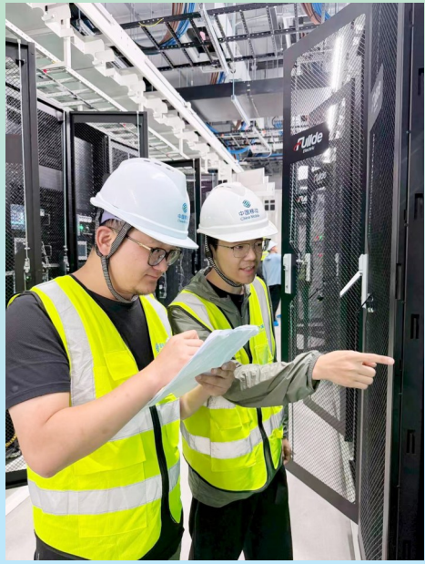
▲在中国移动(宁夏中卫)数据中心,工作人员对设备进行维护检修。
