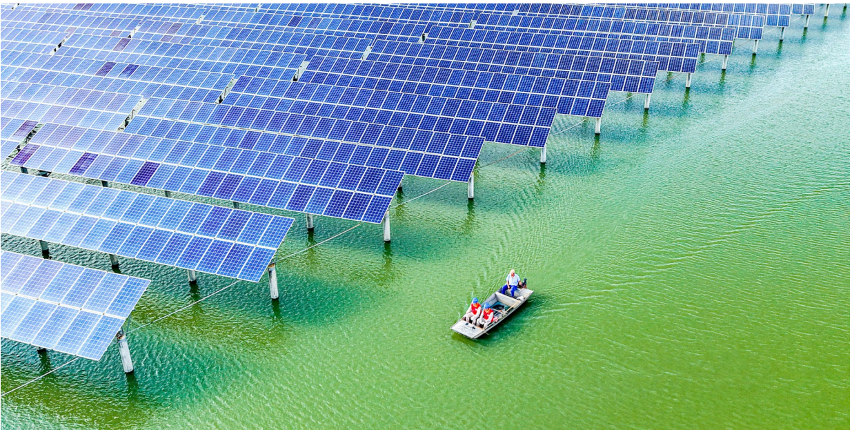
8月19日,在江苏省扬州市邗江区公道镇,电力运维工人在检查渔光互补发电设备运行情况(无人机照片)。 国网江苏省电力有限公司最新统计数据显示,截至2026年7月底,江苏省光伏发电累计装机容量突破1亿千瓦,达10008万千瓦,占全省电力总装机的比重超38%,超过煤电、气电和风电等,成为全省第一大电源。新华社发
