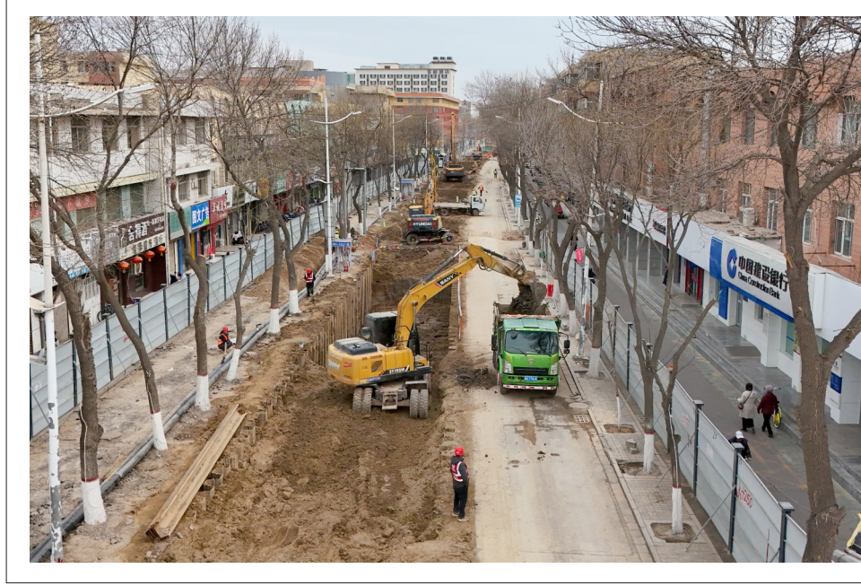
3月17日，贺兰县城市排水防涝体系建设工程(三期朔方街)银河路—桃源路段施工现场作业有序，挖掘机、运输车高效运转。
