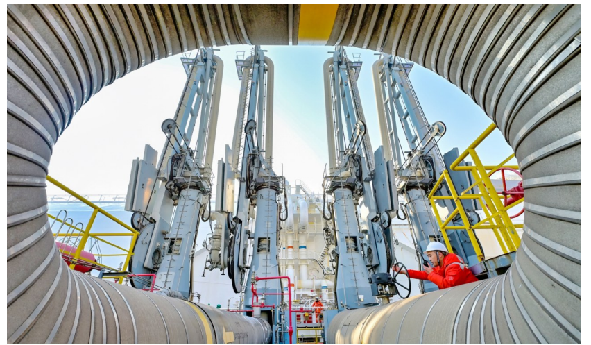
近日,工人在国家管网天津LNG接收站码头巡检。 近日,来自海外的“马斯”号LNG(液化天然气)运输船装载6.44万吨LNG靠泊在国家管网天津LNG接收站码头,这是该接收站在2026年迎来的首船LNG接卸作业。 新华社发
