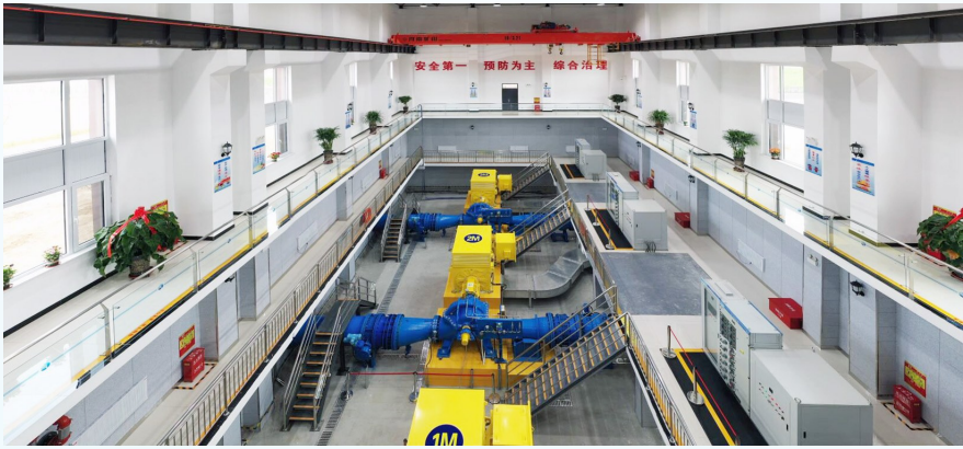
打造现代化灌区标准化泵站。
