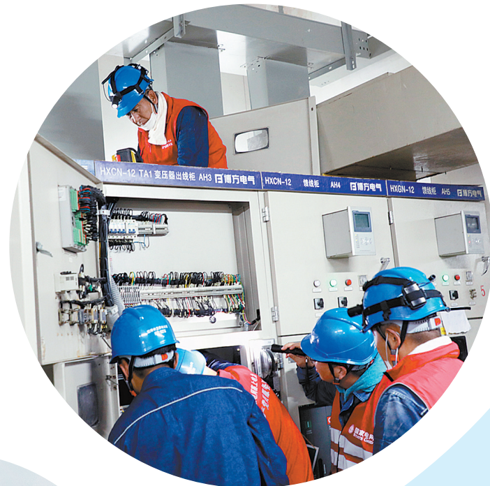
▶ 中卫供电公司的突击队员为配电站房做“体检”。
